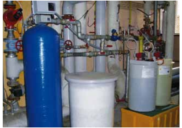
Poste de traitement d'un circuit de tour aérorefrigérante
