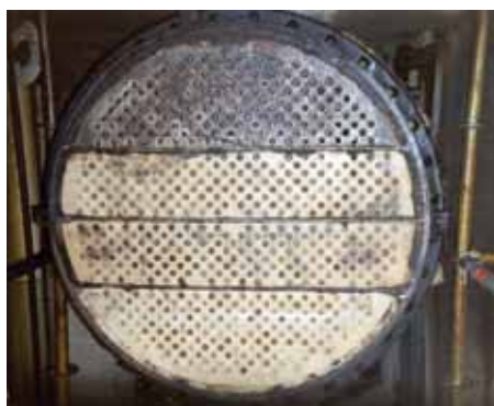
Échangeur de chaleur entartré
